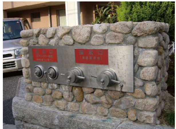
消火設備（送水口等）を石積みすることで、まちなみに配慮する
