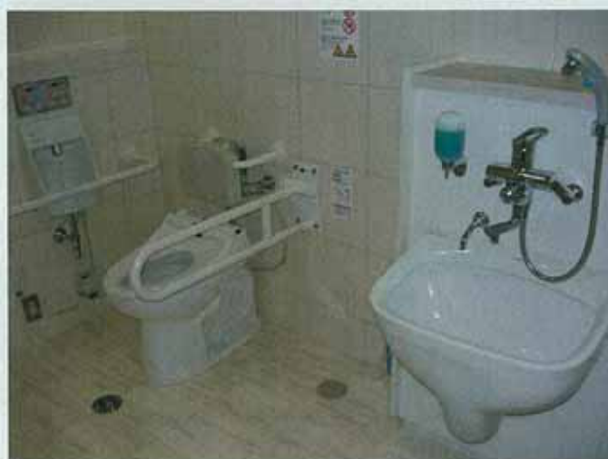
オストメイトを備えた多目的トイレ (別館3F)
