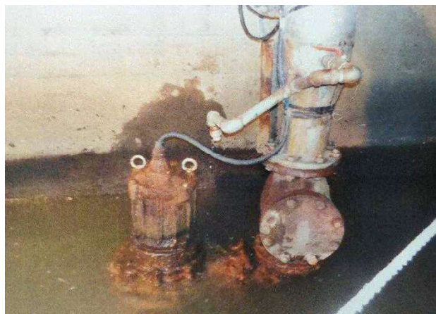
写真2 設備の老朽化状況
