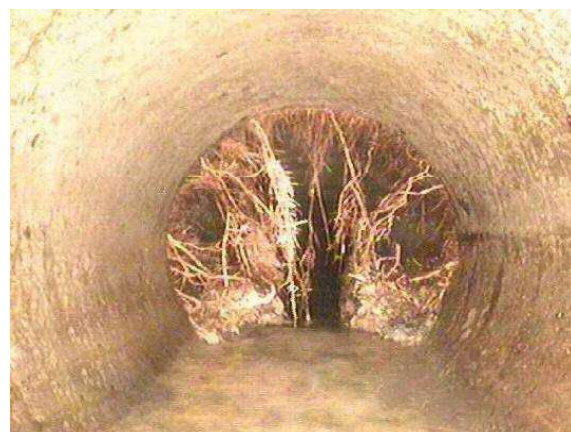
写真1 管路の老朽化状況
