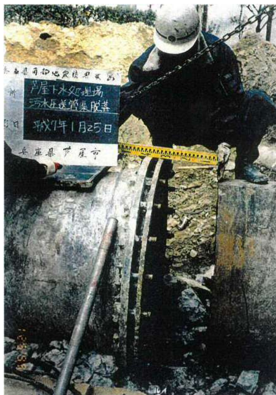
汚水管路の脱落
