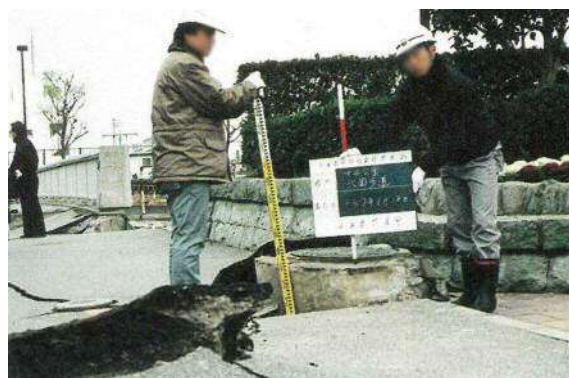
液状化によるマンホール突出
