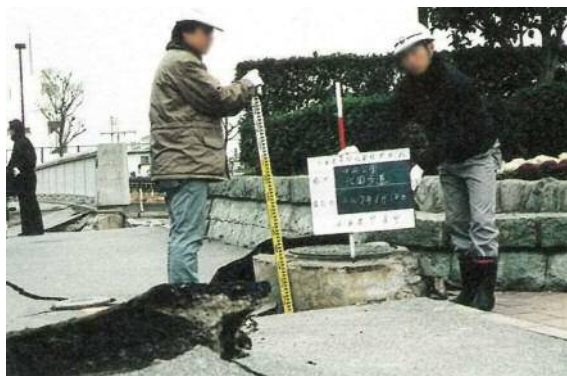
液状化によるマンホール突出
