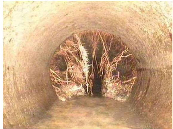
写真1 管路の老朽化状況
