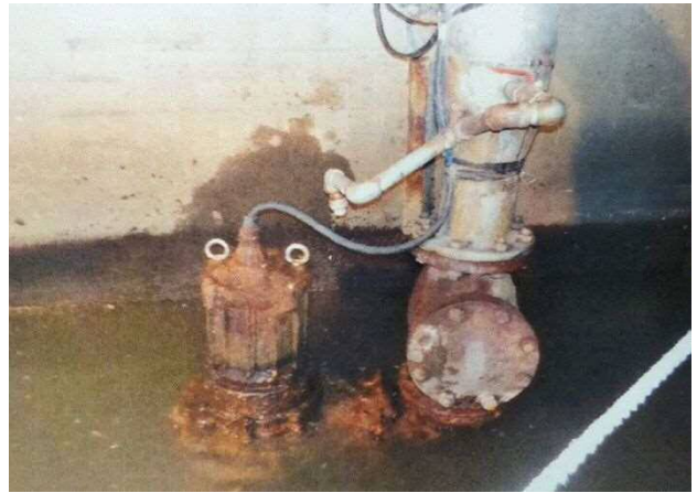
写真2 設備の老朽化状況
