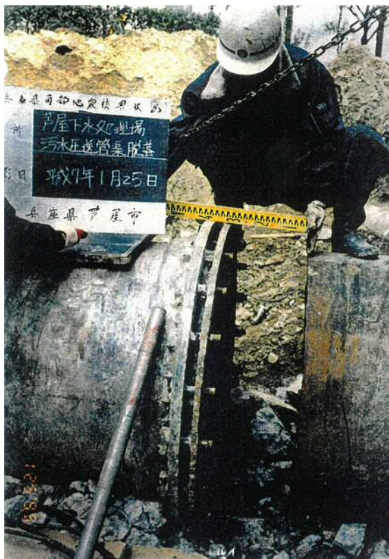
汚水管路の脱落
