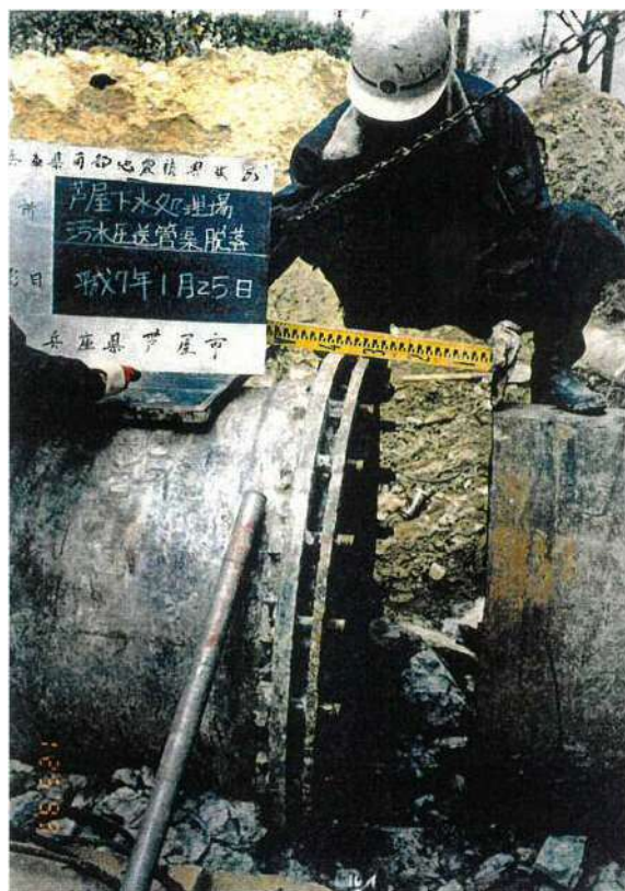
汚水管路の脱落
