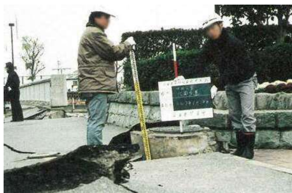
液状化によるマンホール突出
