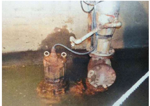
写真2 設備の老朽化状況
