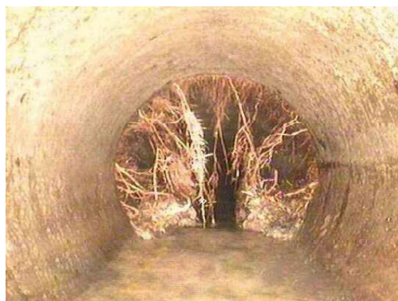
写真1 管路の老朽化状況
