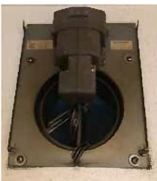
陽光町市営住宅の玄関側にある換気口
