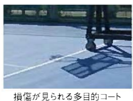
損傷が見られる多目的コート
