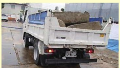
施設予定地から出てきた地中障害物
