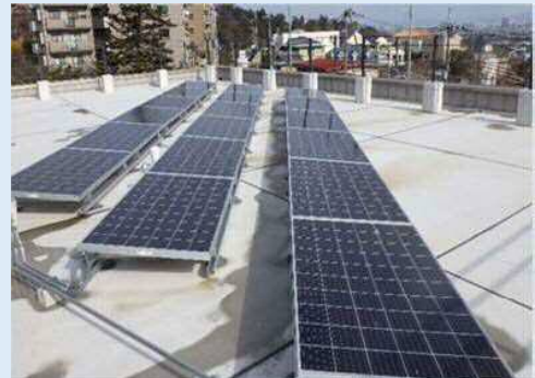
芦屋市霊園事務所に設置した太陽光発電システム
