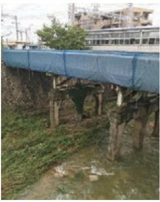
土石、流木などが堆積し土砂ダムが発生する危険がある築63年の桜橋（阪急芦屋川駅の北側）
