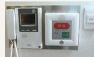
緊急通報システムの装置
