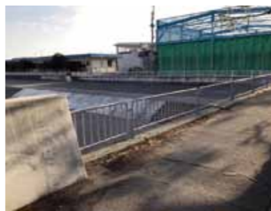
防潮堤の途切れた箇所(江尻川河口部西側)
