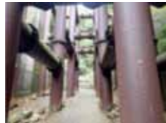
芦屋川上流に設置されている透過型の砂防ダム「鷹尾第二堰堤」
