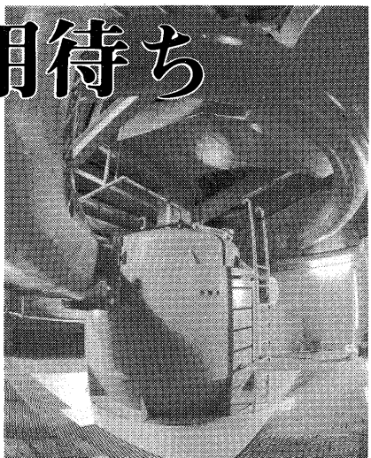
環境処理センターにある分離器
