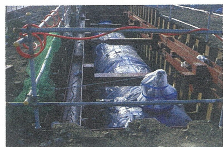
耐震性飲料・消火兼用貯水槽(容量100トン)
