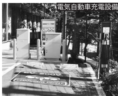
電気自動車充電設備
