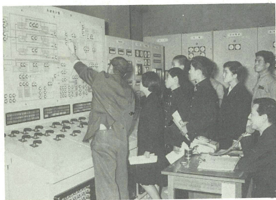
機械を監視し調節する西宮の下水道処理場の電気室
