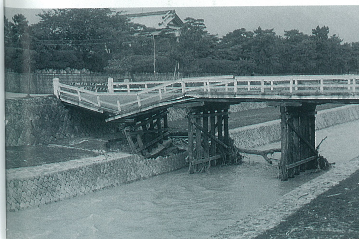
豪雨で倒壊した公光橋 昭和42年
