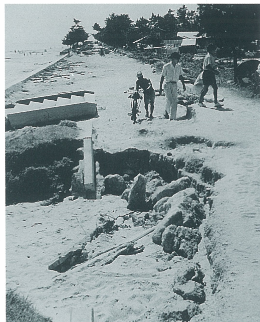
ジェーン台風での防潮堤の決壊 伊勢町付近 ジェーン台風による高潮によって東西150メートルにわたって決壊し、民家に大きな被害をもたらした。
