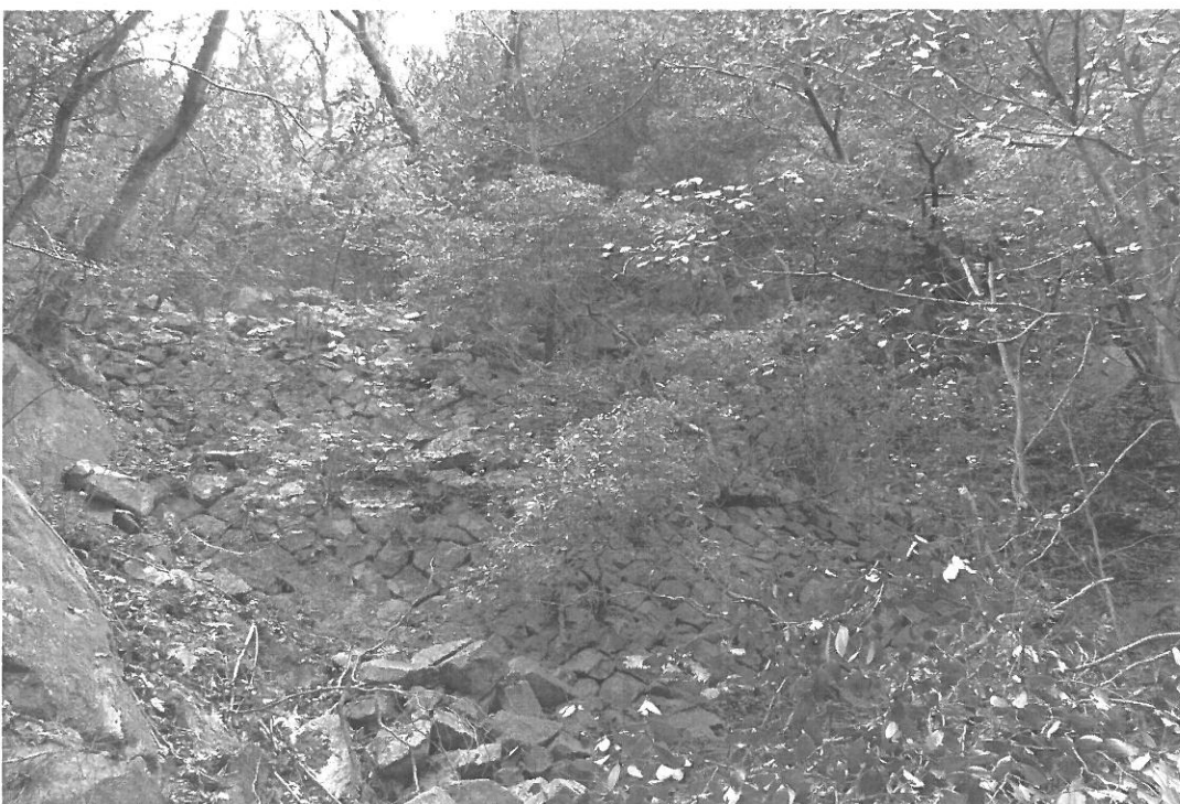
共有山上流側 石積み崩落箇所
