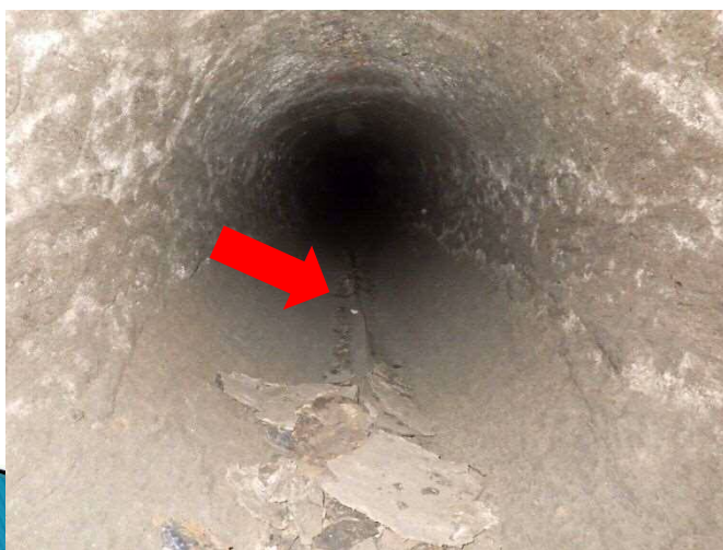
穴あき（亀裂）状況（輸送管の内側）
