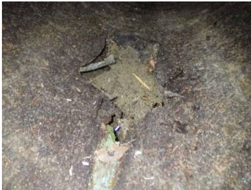
穴あき箇所①-1 補修前
