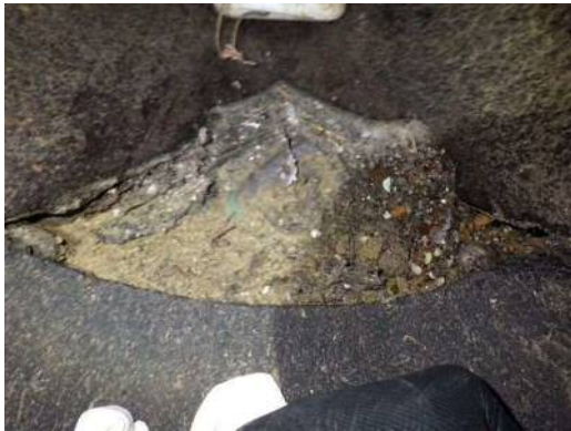
穴あき箇所①-1 補修前
