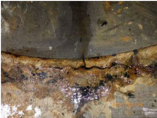
③-1 目地部補修前 (内貼り材目地部の亀裂)
