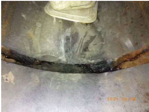
③-3 目地部補修前 (内貼り材目地部の欠損)
