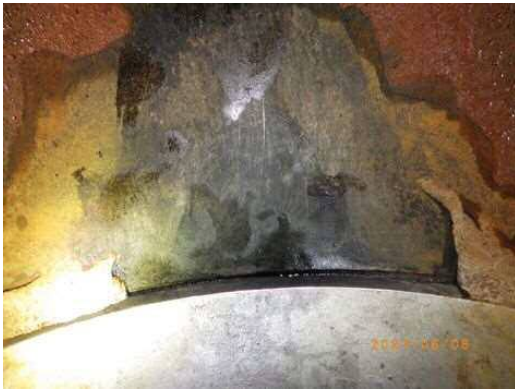
③-2 目地部補修前 (内貼り材目地部の欠損)
