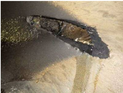
穴あき箇所② 補修前
