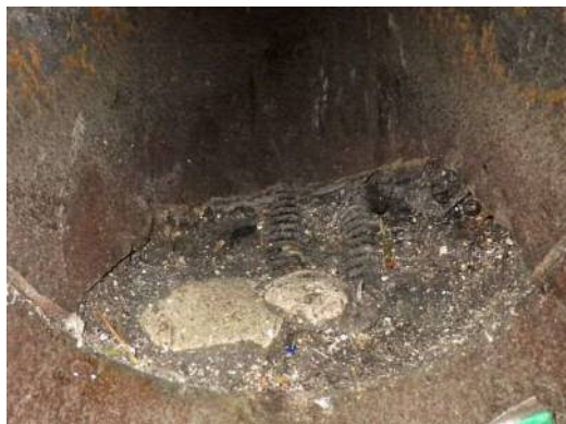
穴あき箇所①-2 補修前
