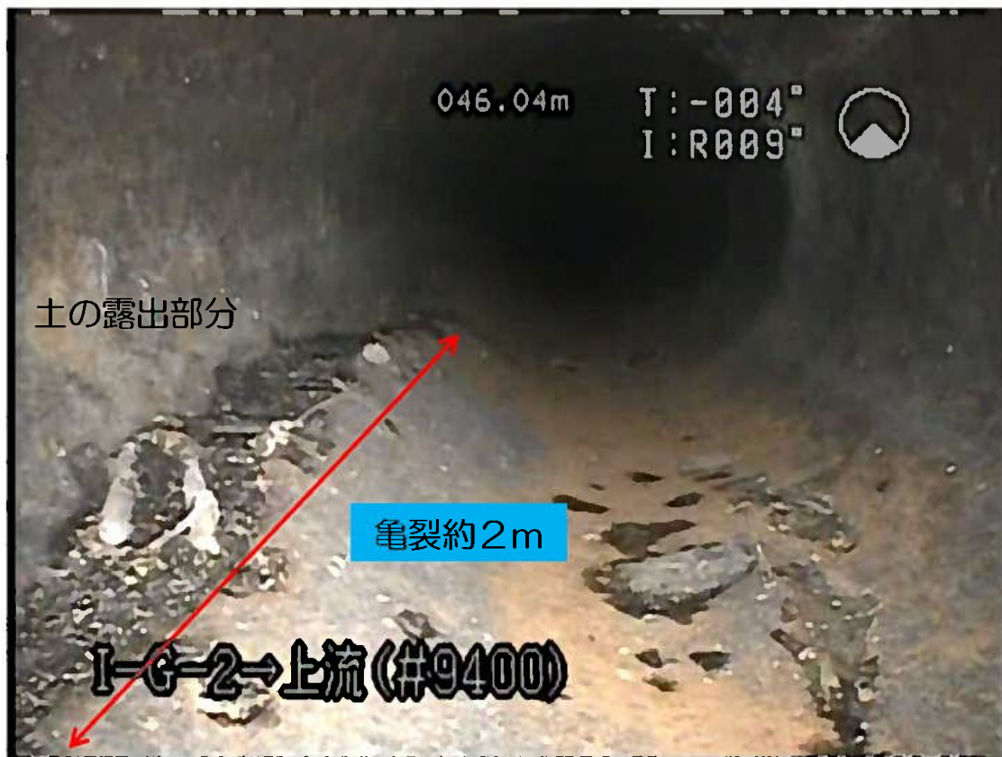
輸送管内の亀裂 (約2m)
