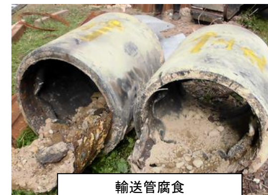
輸送管腐食(約1700X200mm) 2016年8月(浜風町10)
