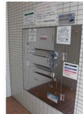
ごみドラム投入口
