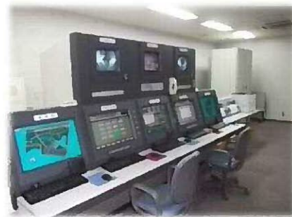
パイプライン施設 中央制御室
