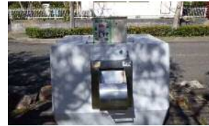
パイプライン収集口
