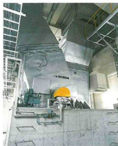
誘引送風機 焼却炉で発生する排ガスを煙突へ誘導します。
