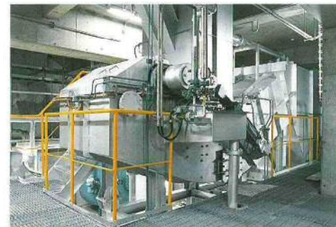
灰押出装置 ごみの焼却灰を冷やして、灰ピットへ送り出します。
