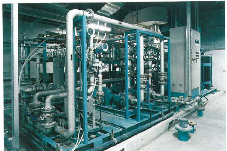
逆浸透(RO)膜処理装置 スパイラル式の逆浸透膜によって、微量有機物、塩類、細菌、ウイルスなどを取り除き、きれいで安全な処理水を作ります。この水は施設内でガス冷却用水・プラントホーム洗浄水・散水用水として再利用します。
