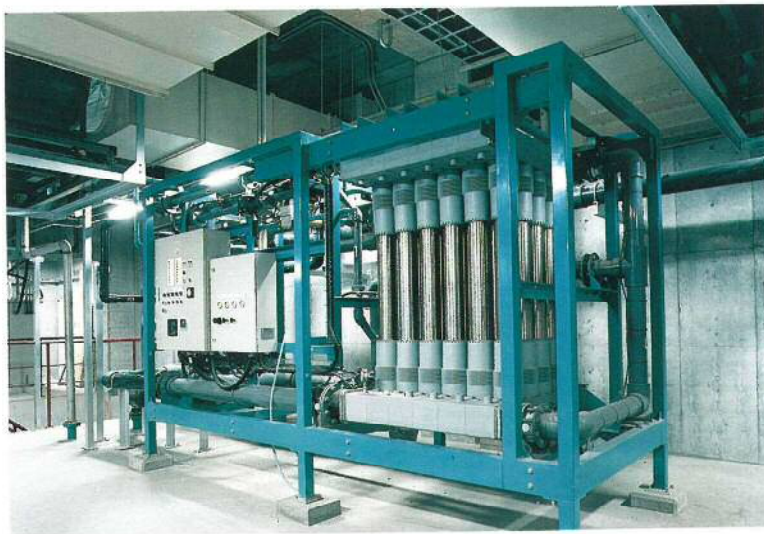
精密ろ過膜(MF)処理装置 下水処理場から送られる二次処理水は、中空糸状の精密ろ過膜を通して汚濁物質を取り除き、逆浸透膜装置へ送ります。
