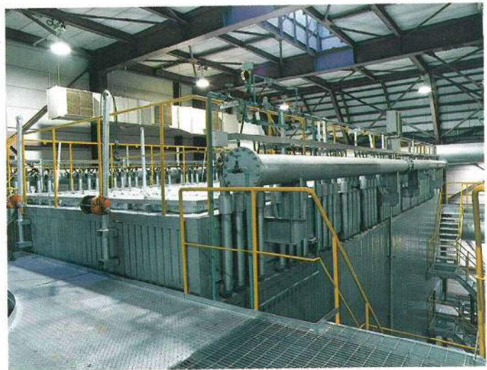
バグフィルタ 耐熱性の布を用いたバグフィルタにより、微細なばいじんまで除去します。
