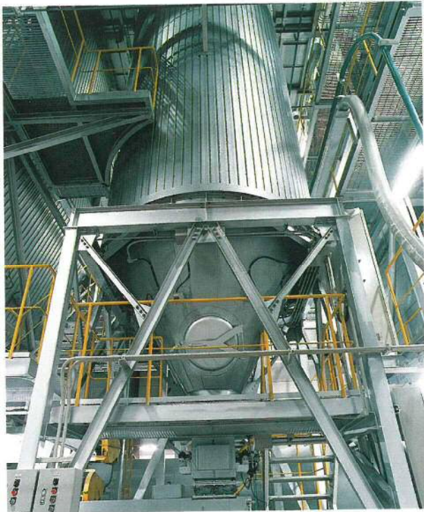
有害ガス除去装置 消石灰を排ガスと反応させて、塩化水素や硫黄酸化物を除去します。
