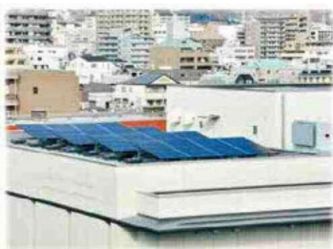
東館屋上の太陽光発電装置
