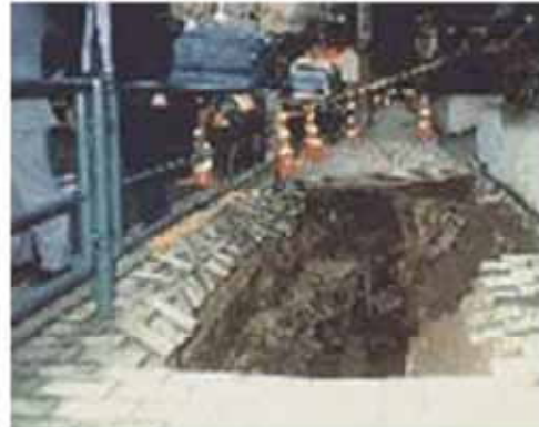
道路陥没状況
