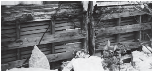
11-23 阪神・淡路大震災の全壊住宅（モルタルが落ちて腐朽した壁が露出した。管理の重要性を再確認）
