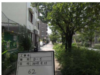
建築限界の侵害（歩道側）
