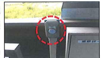
現状の非常停止ボタン
