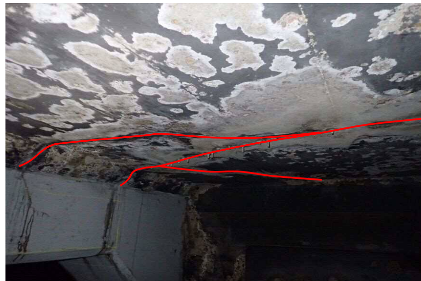
上部構造（床版）漏水・遊離石灰
