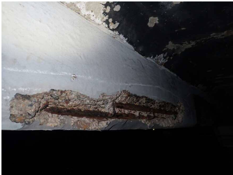
上部構造（主桁）鉄筋露出
