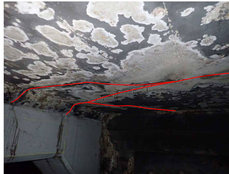
上部構造（床版）漏水・遊離石灰
