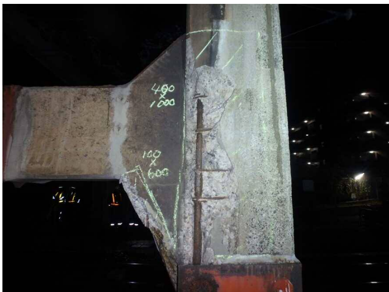
下部構造（橋脚）鉄筋露出
