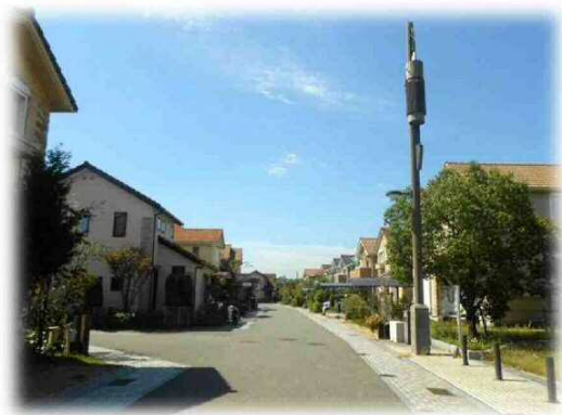
柱上型機器（海洋町）
